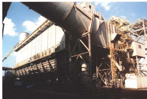
CFT Filteranlage zur Entstaubung eines ägyptischen Stahlwerks
